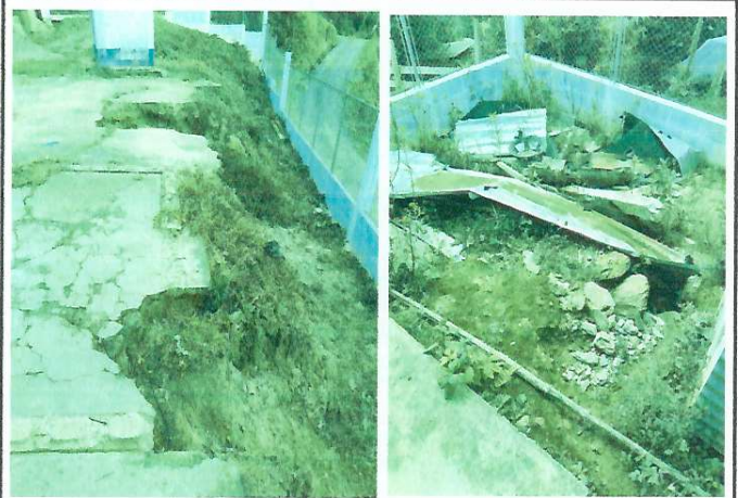
Foto 2: en el patio de la escuela es necesario reparar una parte del muro de contencion ya que fue dañana por las fuertes lluvias.
