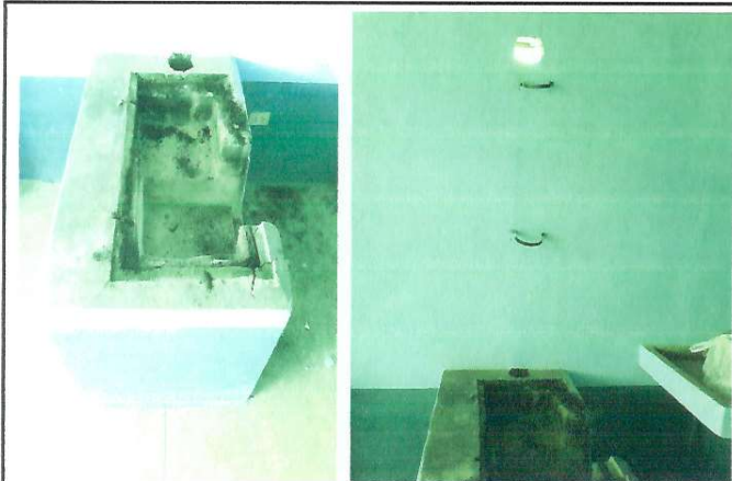
Foto 3: en el área de la cocina es necesario reparar la estufa ya que está en mal estado para la preparacion de la refacción escolar.
